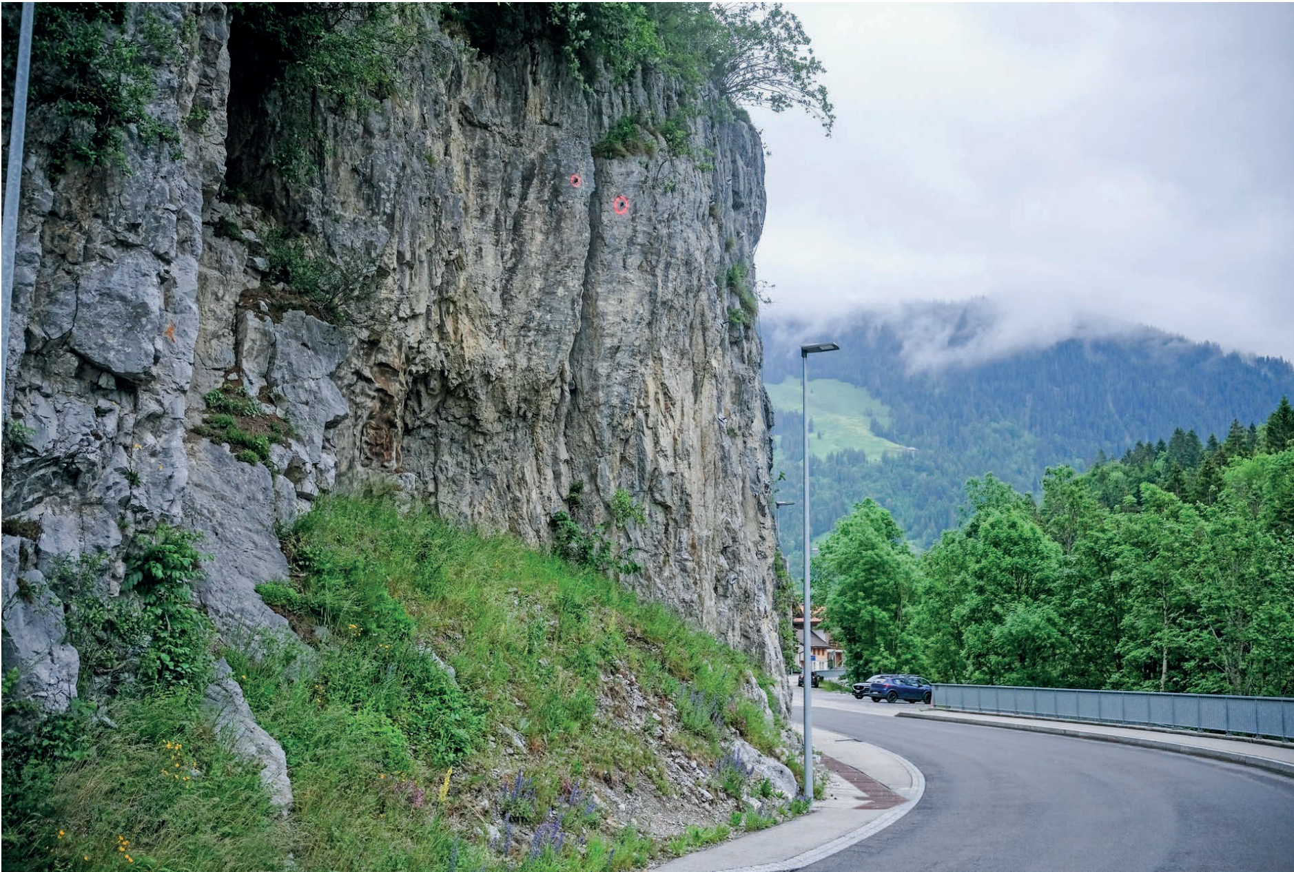
Aus Sicherheitsgründen wird die Felswand in Jaun bald saniert.
